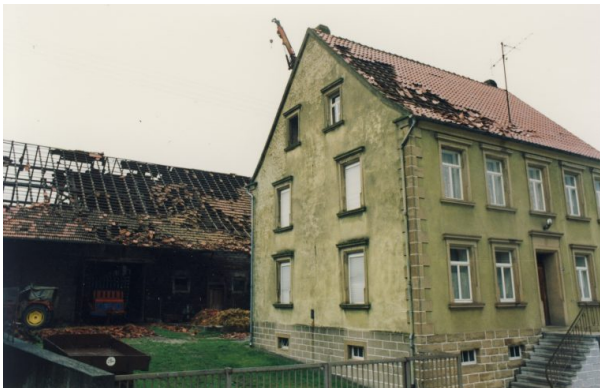
Schäden am Bauernhaus Biehl nach dem Tornado 1993 (OG Hinzweiler/ Werner Lang, 1993)
