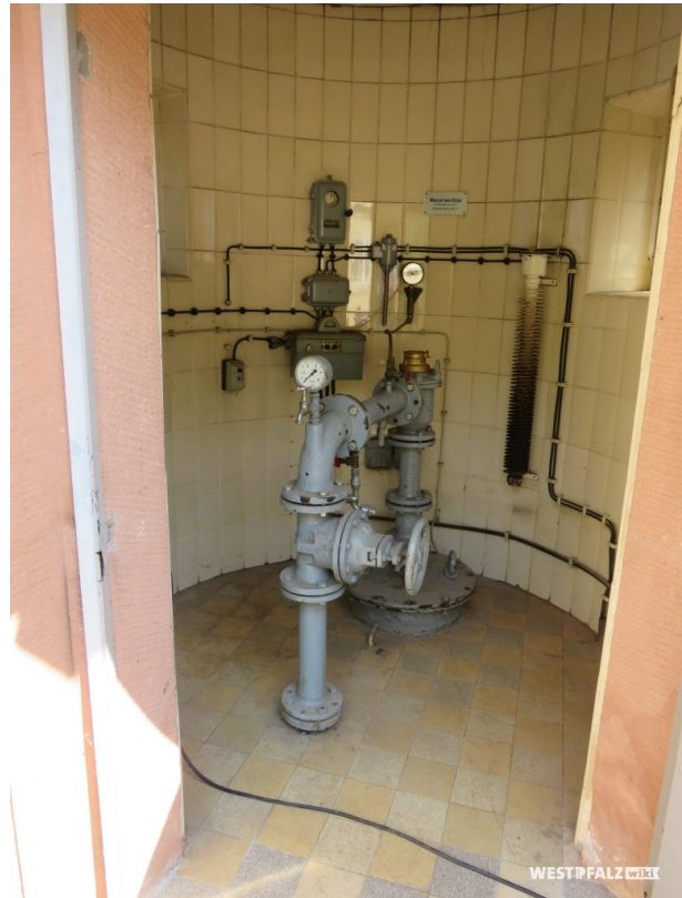
Pumpenhaus am Röhrbrunnen in Erfenbach (Helge Ebling, 2018)
