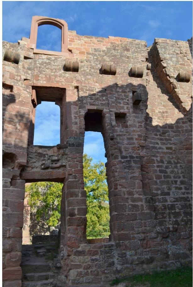
Mehrere Stockwerke aufragende Fassade der ehemaligen Wehr- und Wohnbauten der Burg Hohenecken. (Dr. Hans-Günther Clev, 2018)
