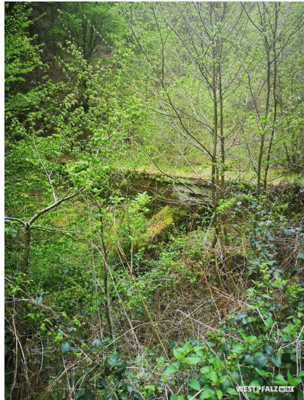
Umwuchertes Absperrbauwerk des Felsenthaler Woogs am Leinbach auf der wasserabgewandten Seite
