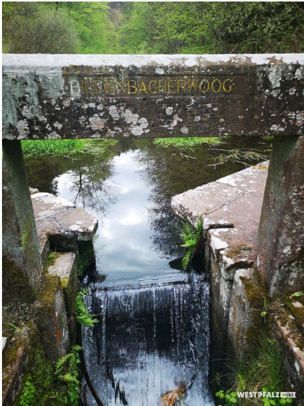
Wasserauslauf am Absperrbauwerk mit Sandsteinfassung, in dem die Inschrift des gleichnamigen Rittersteins integriert ist (Anja Jung , 2019)
